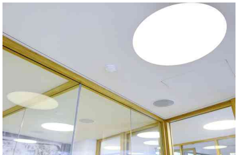
Der Blick an die Decke eines Besprechungszimmers zeigt die ästhetische Verbindung der Passiv-Infrarot-Präsenzmelder zusammen mit den in die Decke eingelassenen Regent-Leuchten.
